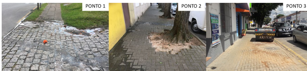
FIGURA 6 – Fotografias de Calçadas – condições dos pontos 1, 2 e 3
